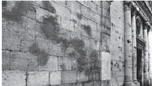
Efectos causados por las bombas en la fachada principal de la iglesia de San Ildefonso. (Detalle)
