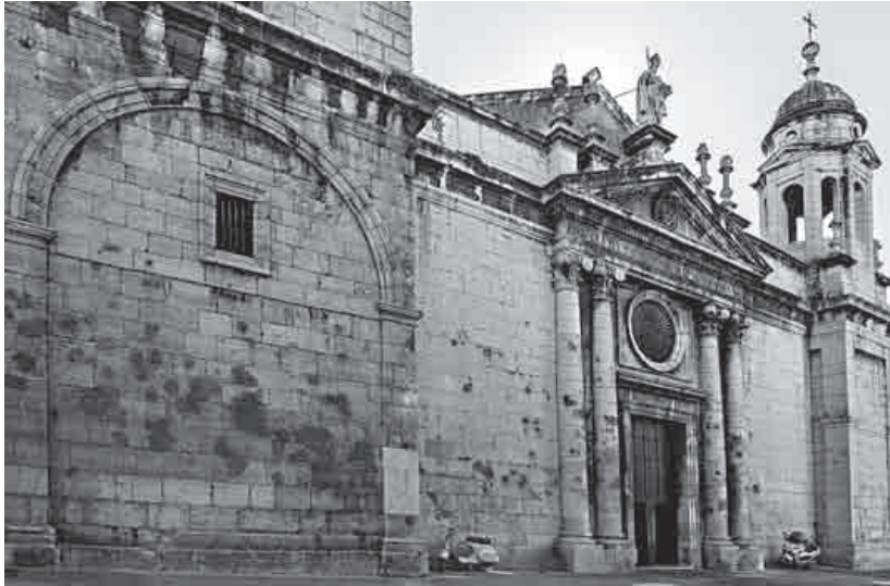
Efectos causados por las bombas en la fachada principal de la iglesia de San Ildefonso.
